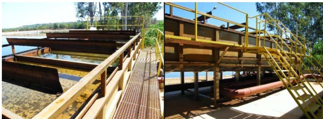
Figura 06: Tratamento terciário – sistema de flotação da ETE Aurenly
