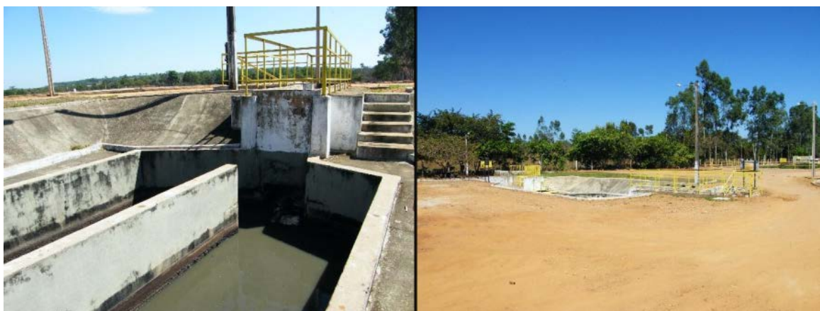
Figura 02: Tratamento preliminar da ETE Aureny
